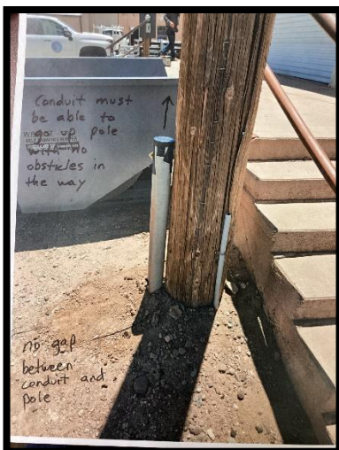
Conduit up pole
